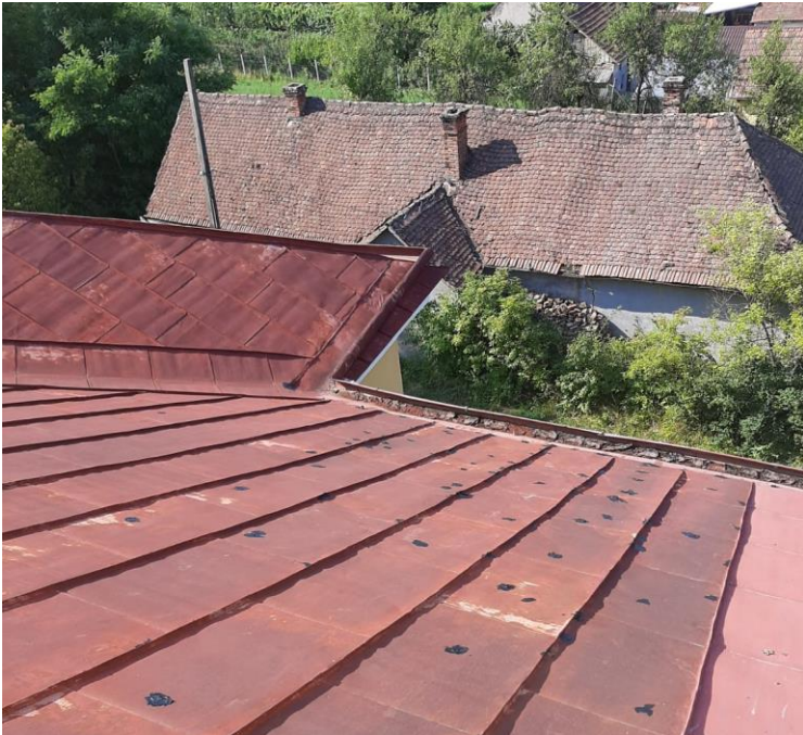
Die Spuren der undichten Stellen auf dem Dach der Kirche
